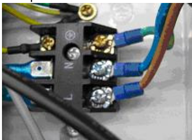
Figure 9: Bornes de branchement au réseau électrique.
